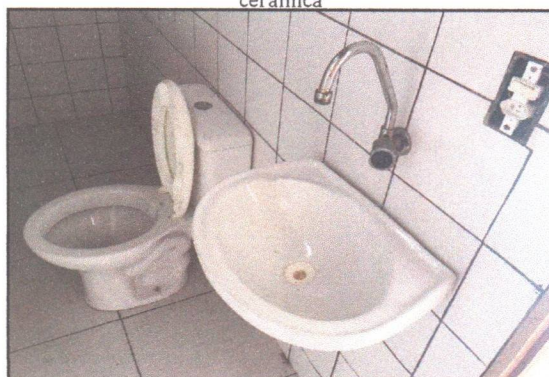
Foto 06: Imagem do Banheiro com pia em louça, sanitário e piso e parede revestidos com cerâmica
