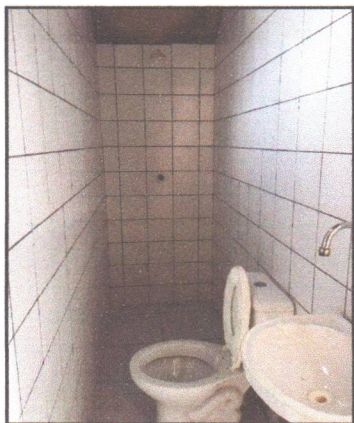
Foto 07: Imagem do Banheiro com detalhe ao piso e parede revestidos com cerâmica
