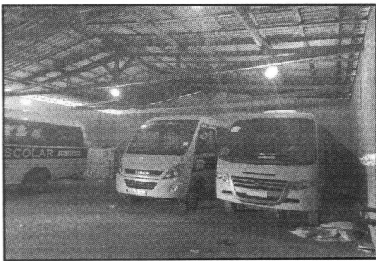
Foto 03: Vista da Galpão, com destaque a cobertura com estrutura com trama de madeira e telha de fibrocimento.
