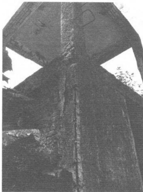
Imagem 05: Fissura Longitudinal que indica a corrosão da armadura dos pilares, com pontos de perda da camada de cobrimento.
