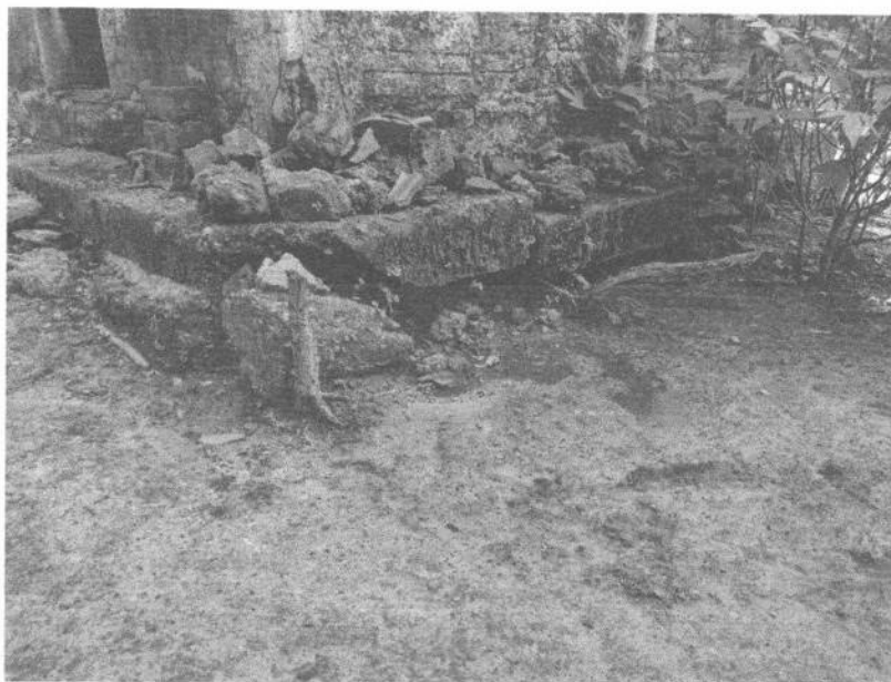
Imagem 09: Entorno da estrutura já se encontra em estado avançado de deterioração.
