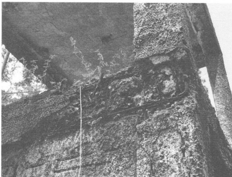
Imagem 07: Estribos da viga expostos, com presença de alto grau de corrosão, indicando seu rompimento.
