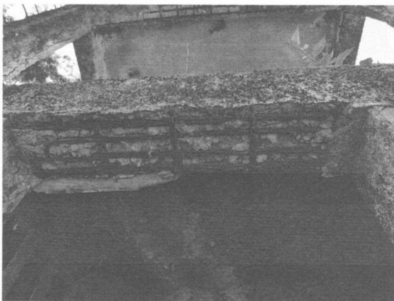
Imagem 06: Armações e estribos da viga expostos, com presença de alto grau de corrosão das armações e deslocamento do cobrimento de concreto.
