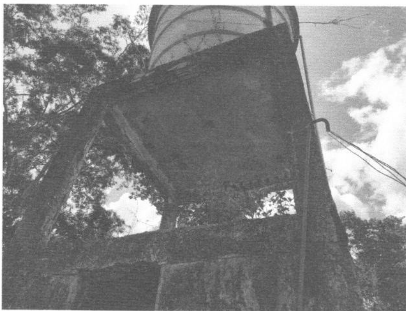
Imagem 08: Armação de viga superior com elevado índice de corrosão, apresentando exposição e deslocamento do concreto.
