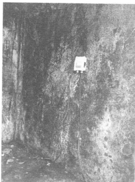
Imagem 10: Instalação elétrica com cabos expostos, com destaque as manchas pretas no concreto causadas pela ação de microorganismos.
