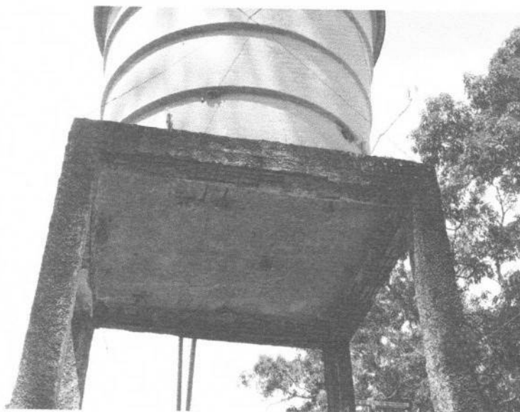
Imagem 12: Aspecto de deterioração da laje, com fissuras em viga superior, com exposição da armação e deslocamento do cobrimento de concreto.
