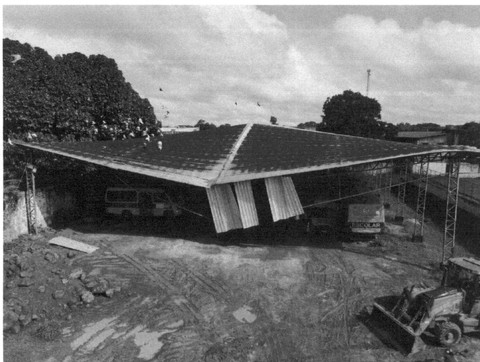
Figura 03: Imagem da cobertura metálica após o colapso de parte da estrutura (01/02/2023).
