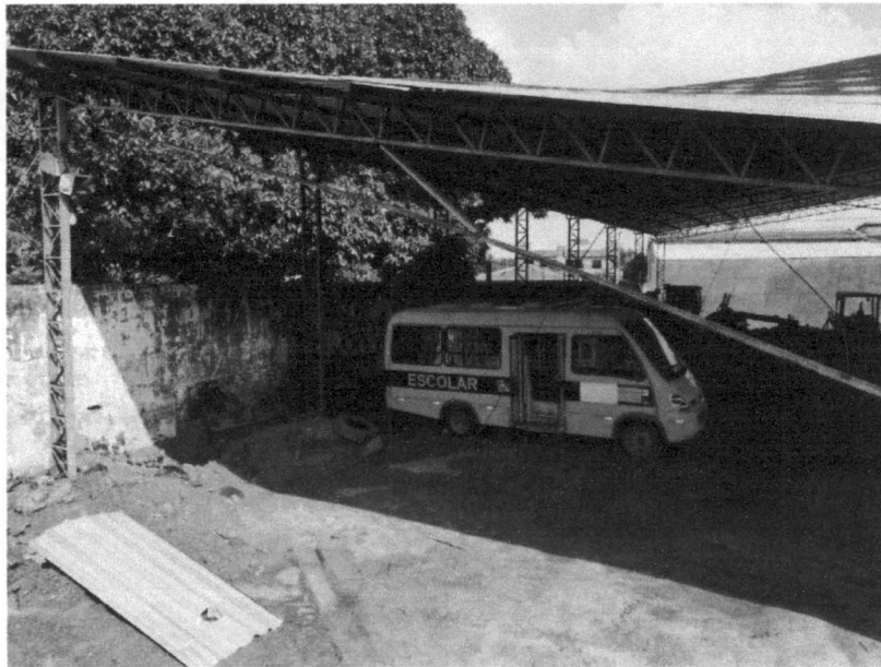
Figura 08: Imagem externa exibindo a deformação na treliça metálica frontal que compõem a cobertura deste objeto, por conta do colapso parcial (01/02/2023).
