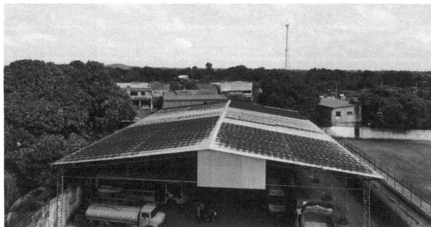
Figura 02: Imagem da cobertura metálica antes do colapso (fevereiro de 2022).
