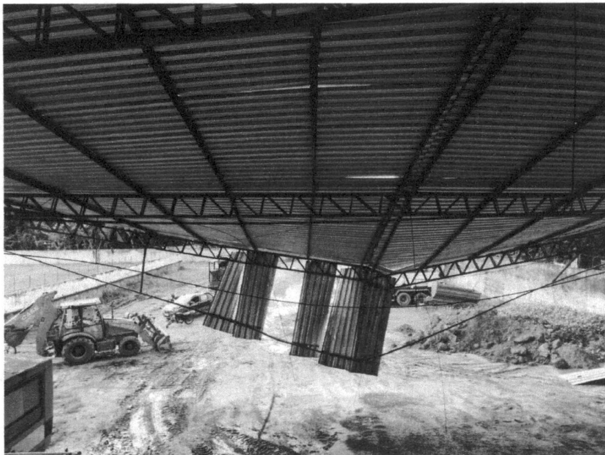
Figura 07: Imagem interna exibindo a deformação nas terças metálicas que compõem a cobertura deste objeto, por conta do colapso parcial (01/02/2023).
