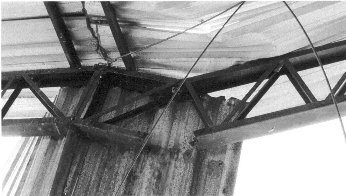
Figura 06: Imagem da treliça metálica após o colapso de parte da estrutura – vista interior. Detalhe para o rompimento da treliça e dos cabos de contraventamento (01/02/2023).
