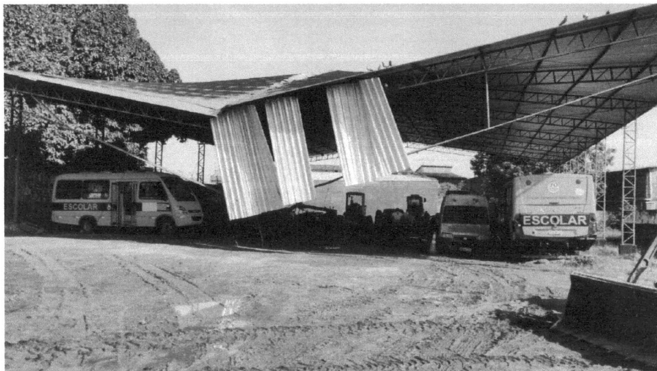
Figura 05: Imagem da cobertura metálica após o colapso de parte da estrutura – vista frontal (01/02/2023).
