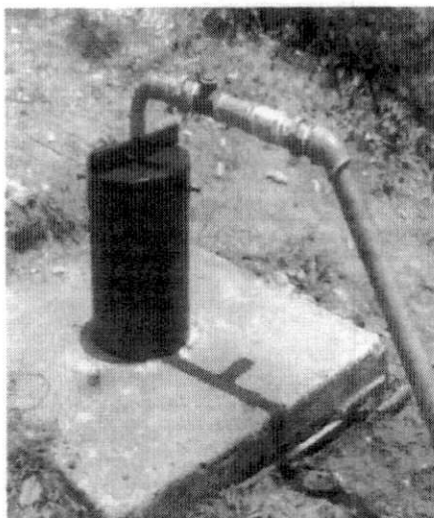
Poço P01 de 6" (Seis) Polegadas
