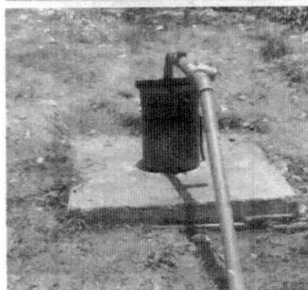
Poço P02 de 8" (Oito) Polegadas
