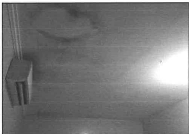
Foto 15: Vista de Umidade em forro de gesso em sala.
