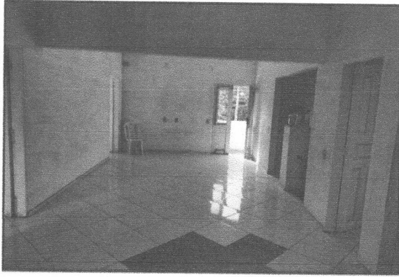
Foto 07: Sala do pavimento superior, com piso em cerâmica, apresentando deplacamento.
