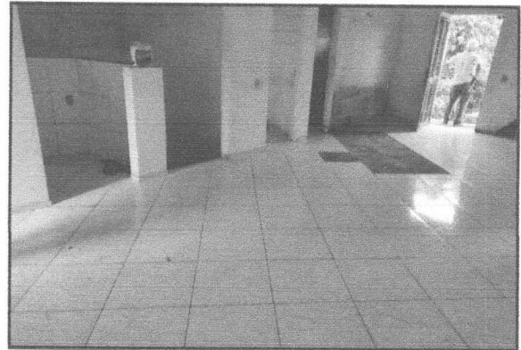
Foto 11: Sala do pavimento superior, com piso em cerâmica, apresentando deplacamento
